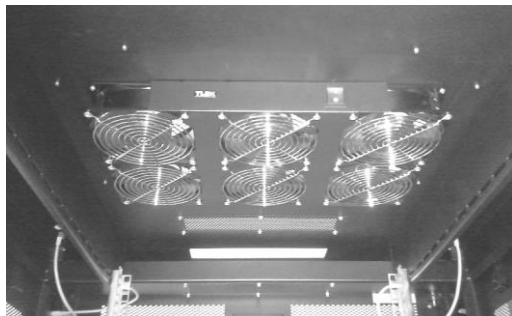
Установленный вентиляторный блок TLK-FAN6-BK
